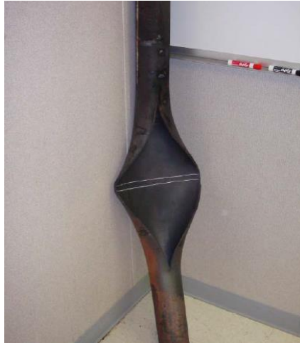
Imagen 7. Falla de un quemador en operación.
