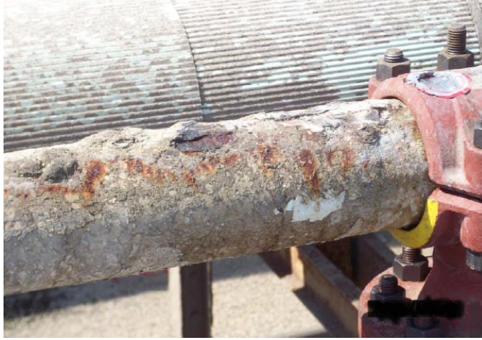
Imagen 1. Corrosión externa por ambiente salino.
