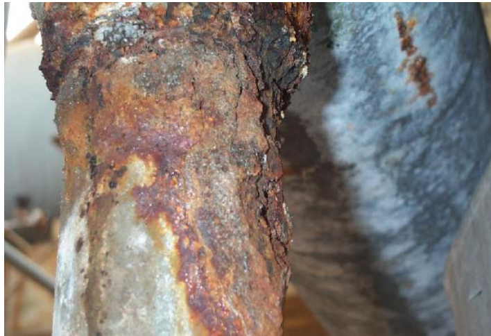
Imagen 2. Corrosión externa bajo aislamiento.
