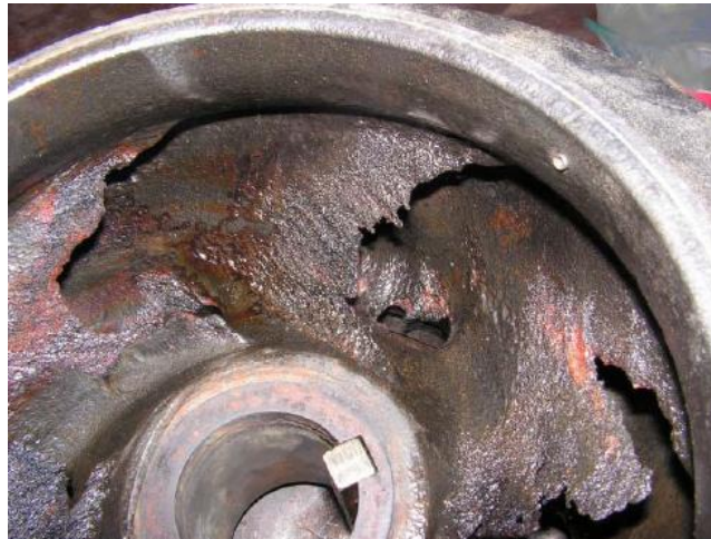
Imagen 9. Erosión en impulsor de una bomba.
