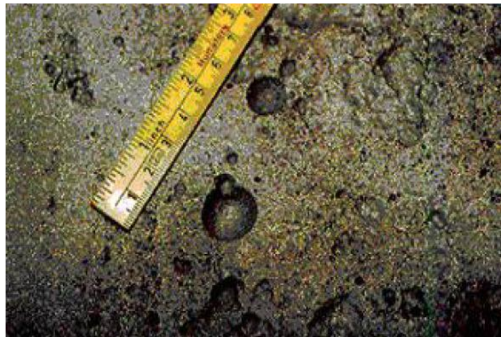
Imagen 4. Corrosión interna por Bacterias.
