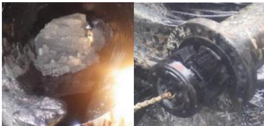
Fotografías 1 y 2. Cantidad de sólidos encontrados dentro del ducto Apaika-ECB y extracción de PIG de limpieza interna atascado
