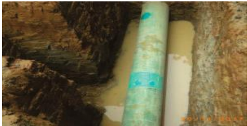
Fotografías 4 y 5. Examinación Directa de las indicaciones del estado del recubrimiento externo, se observan las reparaciones realizadas y se confirmó que no existió pérdida de espesor de la
