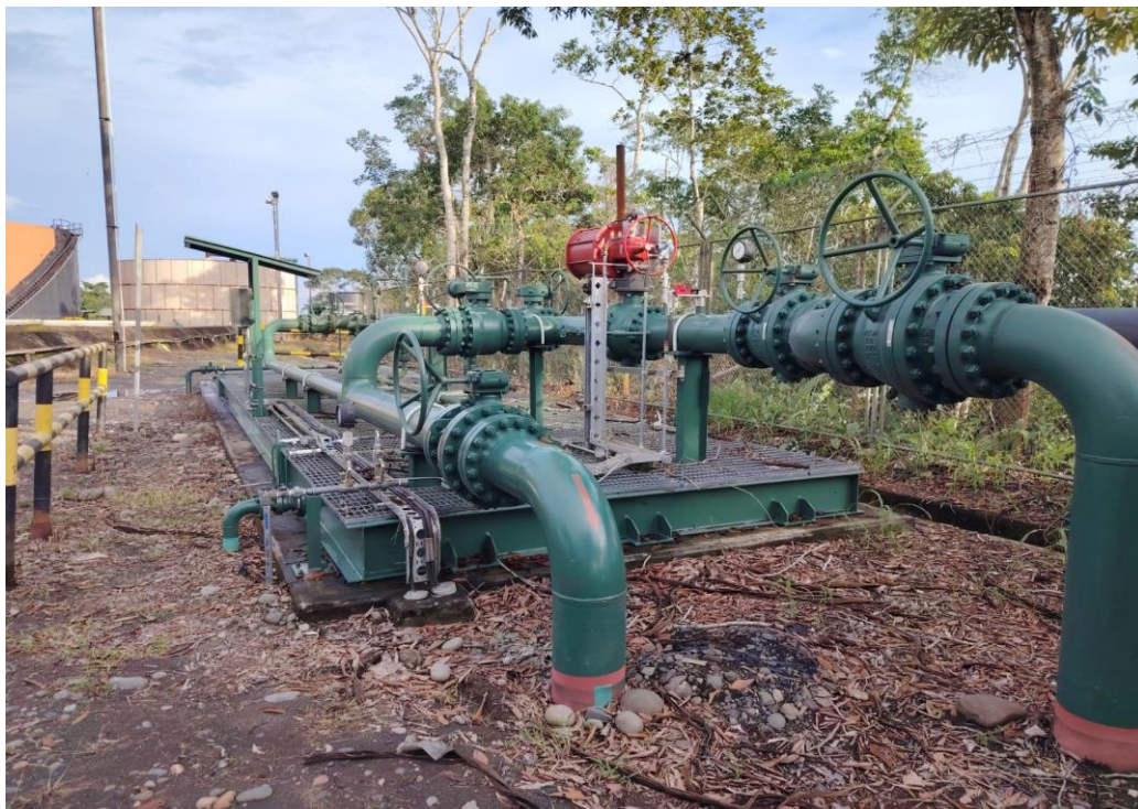
Fotografía 2. Trampa Recibidora de ducto 10 in; ST-ACP-0101
