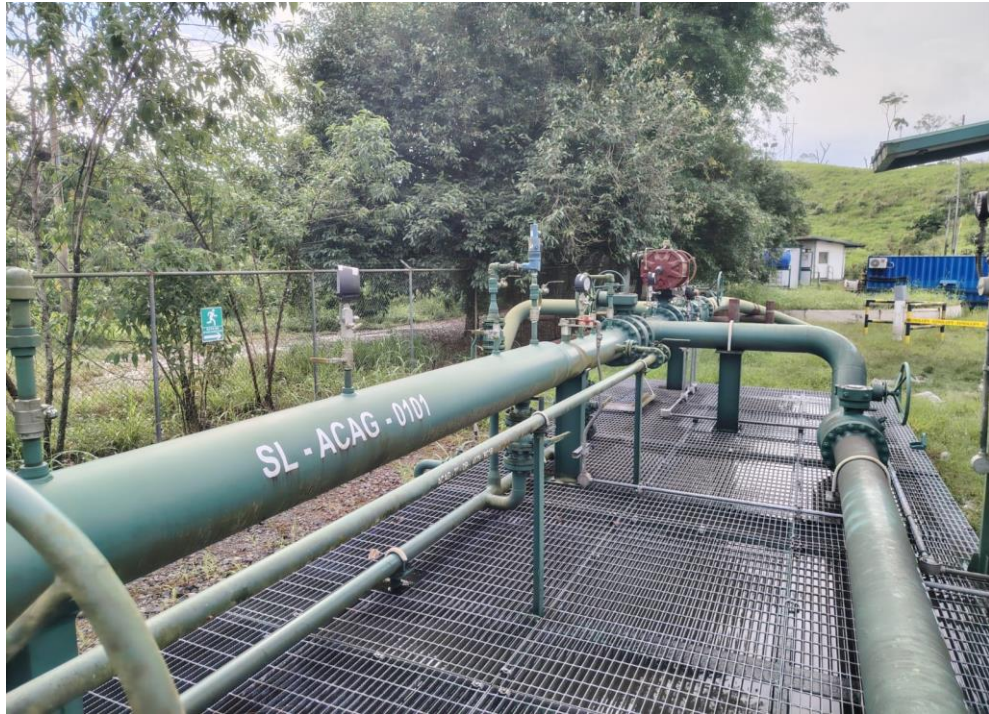
Fotografía 1. Trampa Lanzadora de ducto 10 in; SL-ACAG-0101
