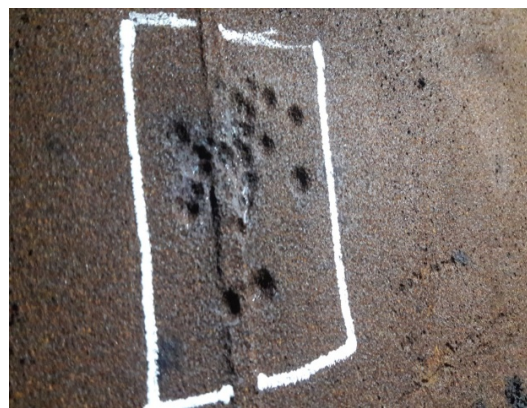
Fotografía Nro. 2: Picaduras pared
