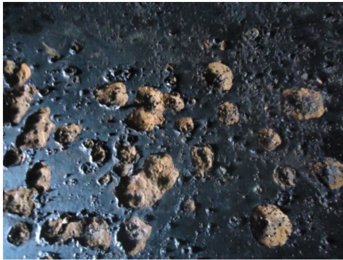
Fotografía Nro. 3: Corrosión localizada piso tanque T-93140
