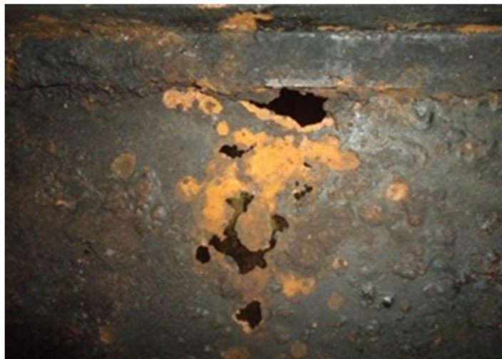
Fotografía Nro. 4: Perforación piso tanque T-93140
