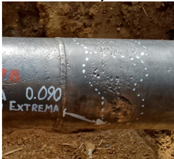
Figura 3 – Corrosión externa debido a desprendimiento de manga termocontraíble.
