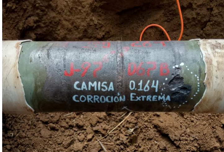
Figura 2 – Corrosión externa debido a desprendimiento de manga termocontraíble.
