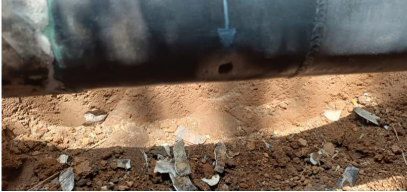
Figura 4 – Perforación debida a corrosión externa.
